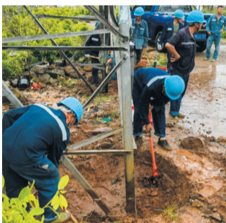
中国电建海南院的抢修队伍在受灾现场抢修电力设备。中国电建海南院供图。
